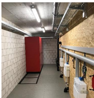
Rastplatz Inseli Hauptverteilung / Technikraum
